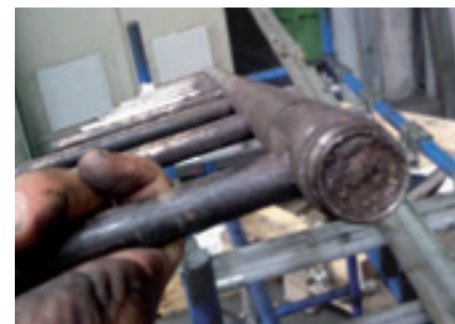
图4 拉丝模喷淋管路被铜泥堵塞
